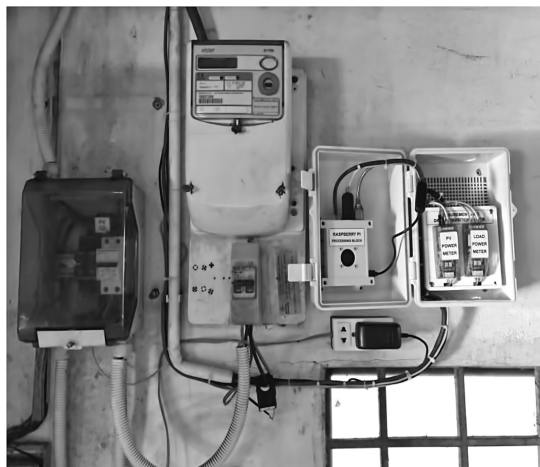
Hình 3. Hệ thống lắp đặt thực tế
